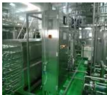
實驗工廠試生產及 生產參數確認
